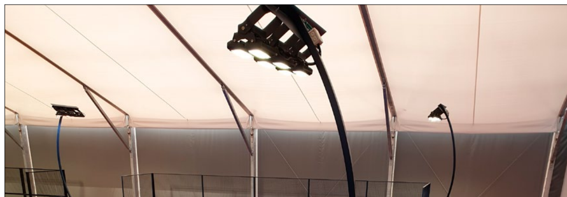
Iluminación de pistas de pádel clase II, instalación 6m altura. Padel court lighting class II, Spain. 6m high installation.
